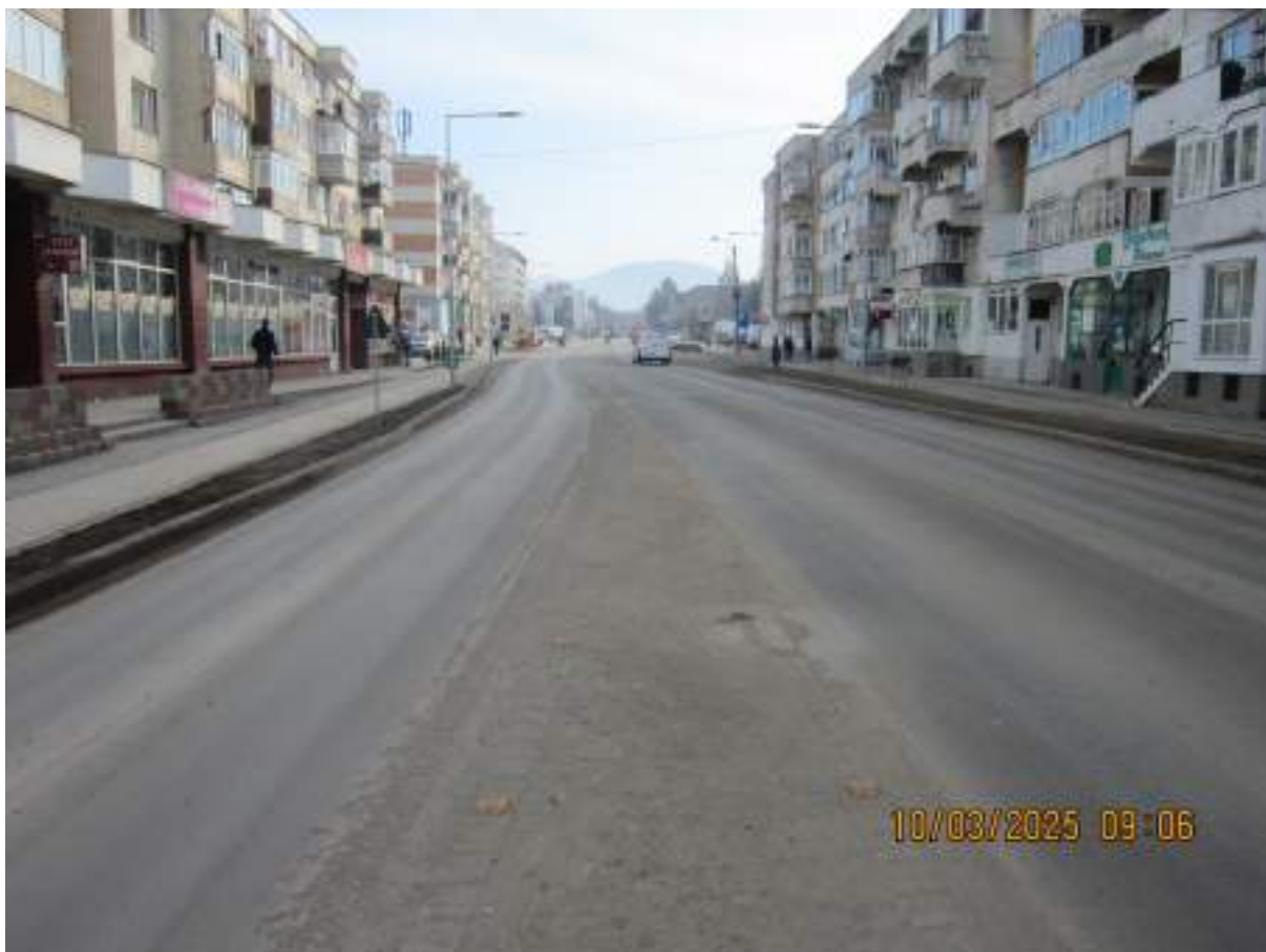
Figură 2-63 Starea carosabilului și a suprafeței pietonale pe Bulevardul Frăției
